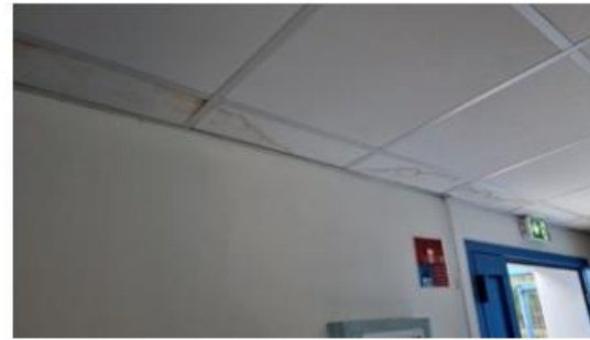
Fuites sur faux-plafonds
