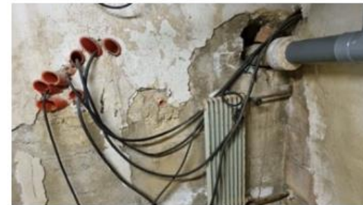
Passage de réseaux
